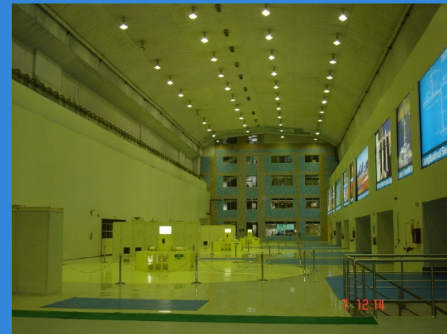
510 MW Teesta – V –Power House
